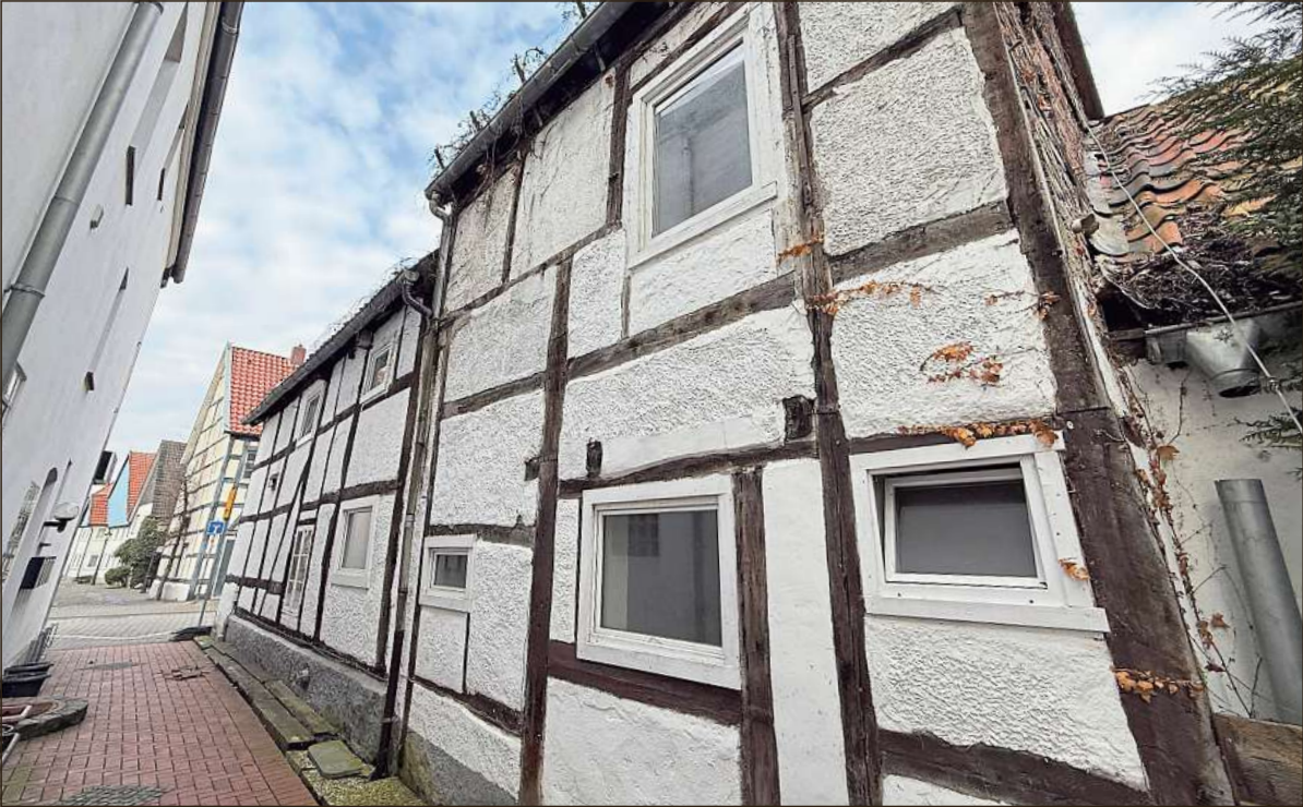
Schon bessere Zeiten hat das Haus Berliner Straße 10 in der Innenstadt gesehen. Das zeigt sich beim Gang um das Gebäude, dessen Grundsubstanz mehrere Jahrhunderte alt ist. Fotos: Sudbrock, Pixabay
