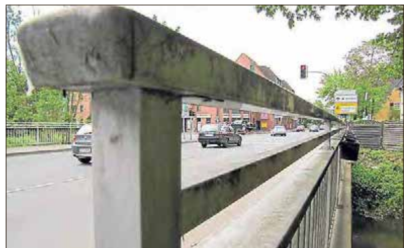
Von herausragender Bedeutung war die Emsbrücke, über die heute die Gütersloher Straße verläuft, schon immer. Bis 1916 markierte sie die Grenze zwischen den Pfarreien Wiedenbrück und Rheda.
