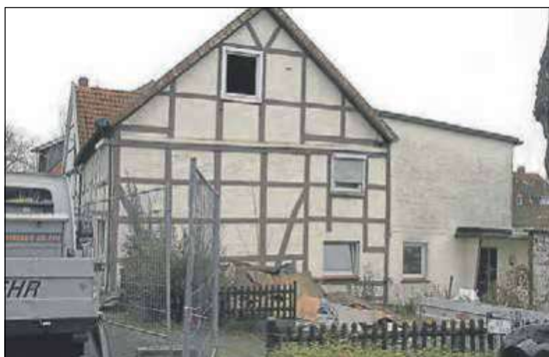
Das nicht denkmalgeschützte Haus am Mühlenwall 5 wird abgebrochen. Auf dem Areal soll ein Neubau entstehen. Bild: Kinder
