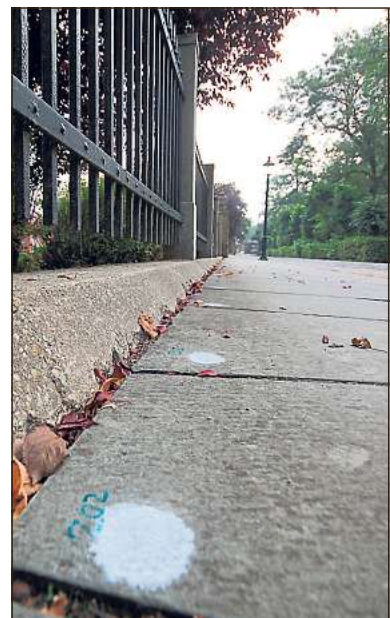
Die mit einem weißen Punkt markierten Platten auf dem Steinweg sollen ausgetauscht werden.
